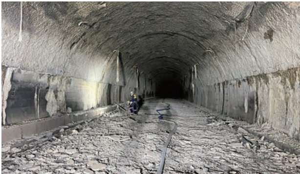
鎮火後の尼子山トンネル坑内
